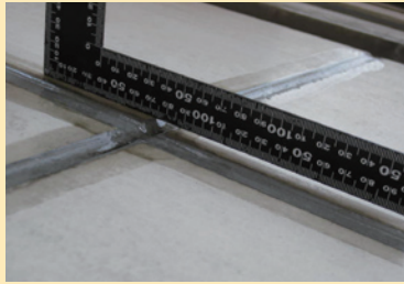
●下地の目地段差
